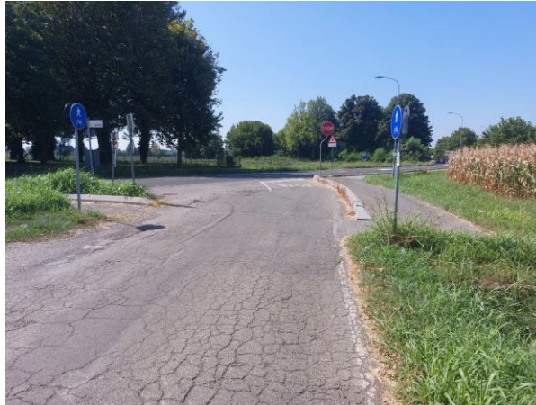
Attraversamento di pista ciclabile su strada veicolare non segnalato
